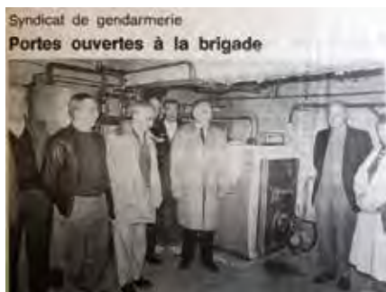
Les élus visitent la nouvelle chaufferie sous la conduite de l'adjutant Gorvan.
