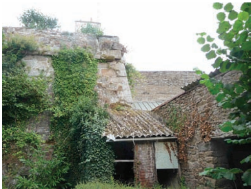
Vestiges de l'ancien château nécessitant un entretien (pierres déchaussées et végétation)
