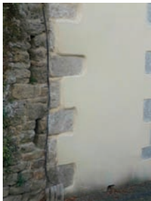
Enduit en surépaisseur inesthétique
